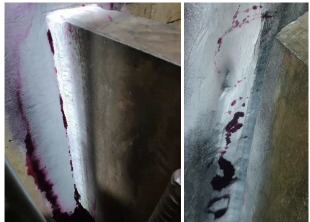
(a) 裂纹打磨前
